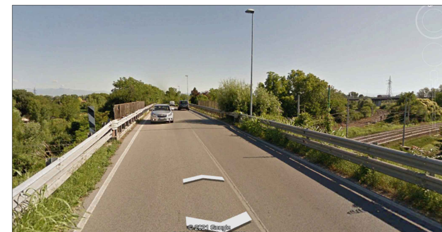
STATO DELL'ARTE DELLA CARREGGIATA DELLA SP463 SUL CAVALCAFERROVIA
