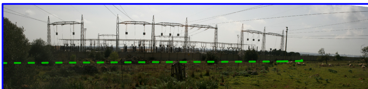
FOTO 49 - Stazione elettrica RTN di Partanna
