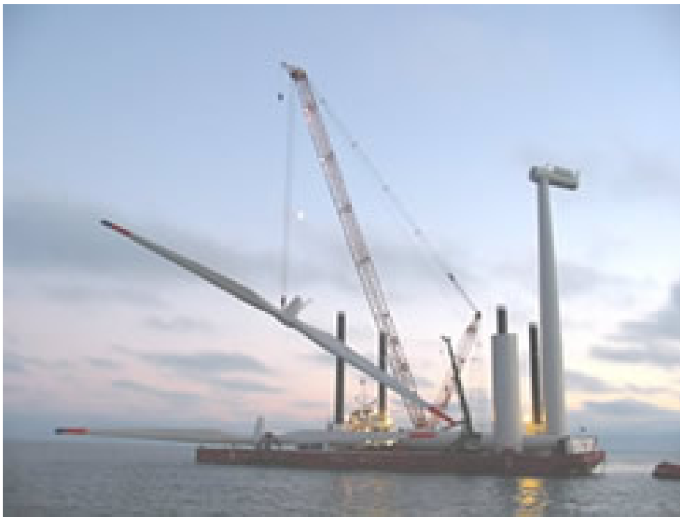
Figura 2-6 Pontone durante il montaggio di un rotore con le pale preassemblate [http://www.c-power.be]
