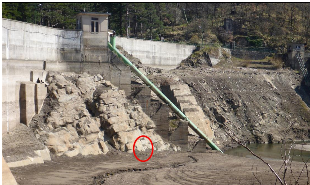
Figura 2 - Panoramica della zona di realizzazione della nuova bocca di presa dello scarico di fondo. In cerchio rosso la posizione della bocca di presa sul versante in roccia, al limite della quota di sedimentazione dei limi lacustri.
