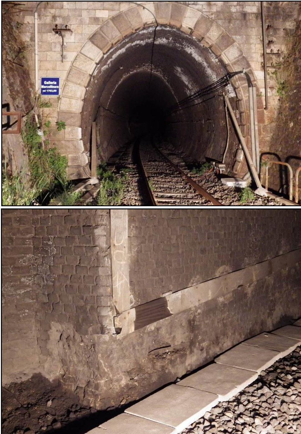
Figura 3.9 - Galleria Marcellinara, imbocco lato Lamezia, progressiva 25+021 e particolare pedritto leggermente ammalorato alla progressiva 25+656.
