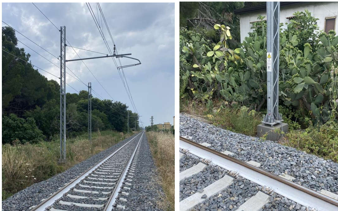
Fig. 2-3 – Esempio di pali per l'elettificazione realizzati lungo la linea ferroviaria ionica calabrese.
