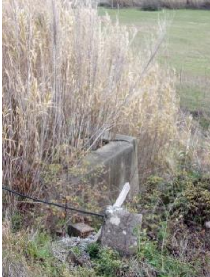
Figura 7-14 – Muro di contenimento esistente lesionato
