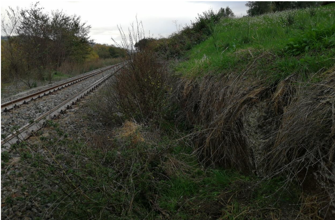
Figura 8-9 – Pk 28 circa – muretto di controripa scavalcato dalle coltri superficiali
