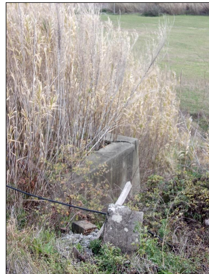
Particolare del tratto terminale del muro di contenimento con evidente dissesto (Foto 4).
