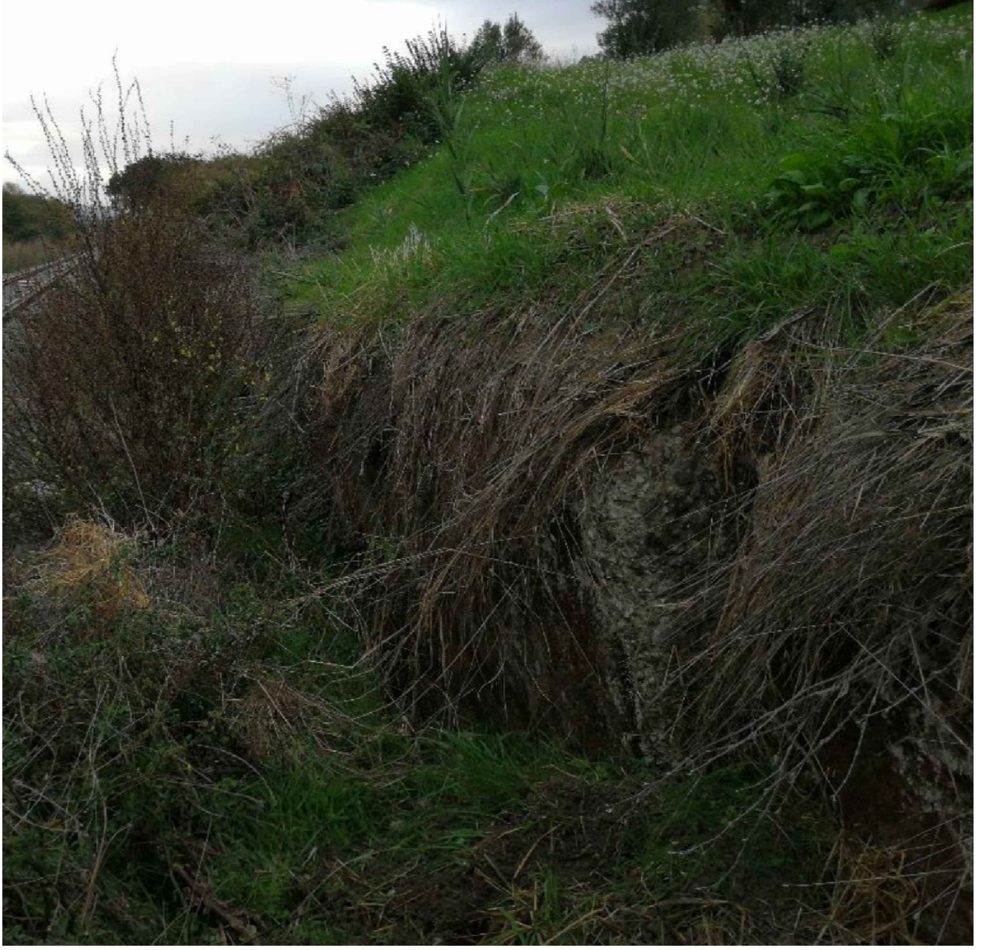
MURO DI CONTRORIPA ESISTENTE FOTO 2
