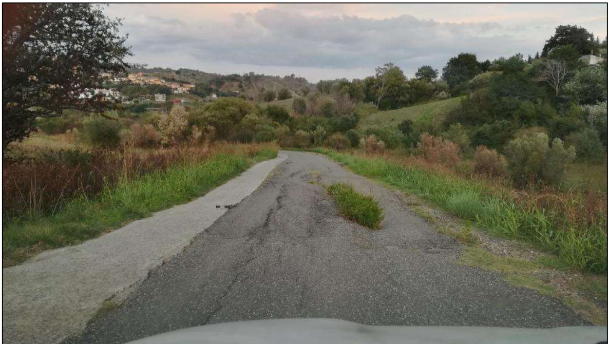
Figura 11-54 - Strada riparata più volte e nuovamente danneggiata.
