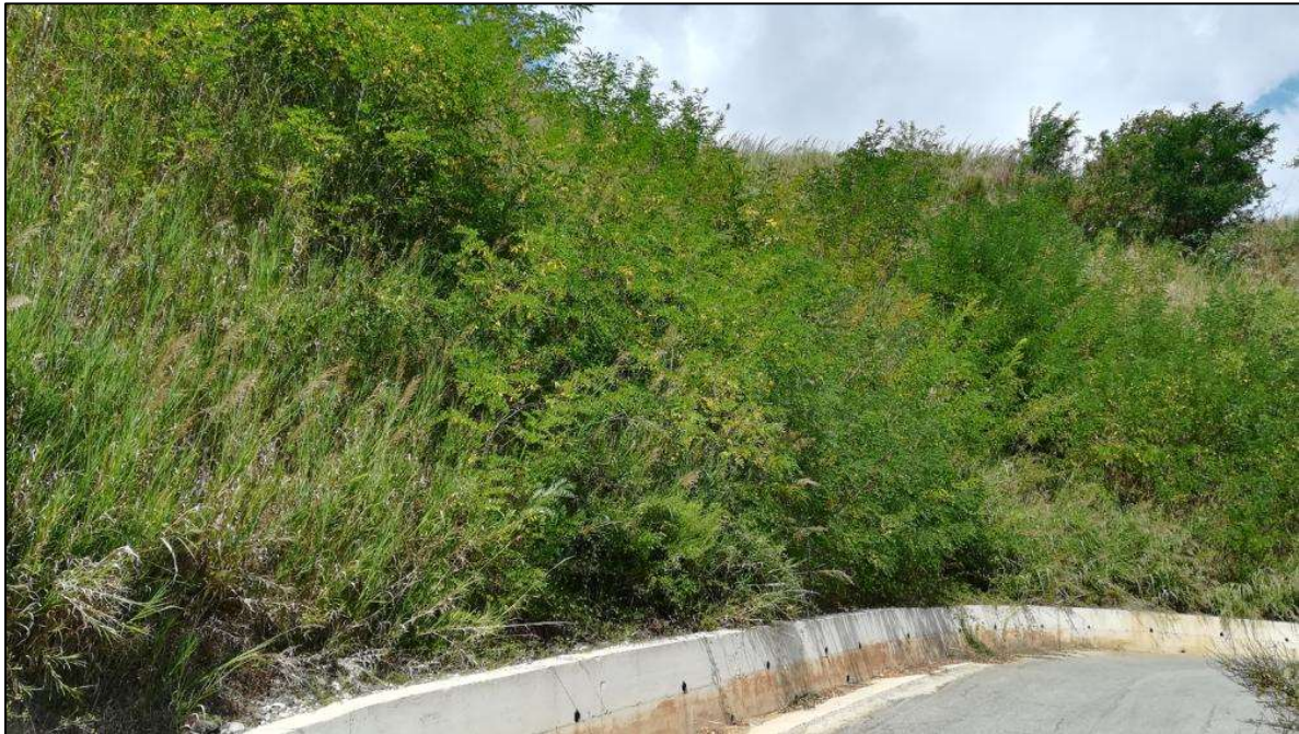
Figura 11-25 - Muretto di contenimento sulla s.s. 19 dir. costruito nel tratto in cui la strada incrocia la linea ferroviaria.
