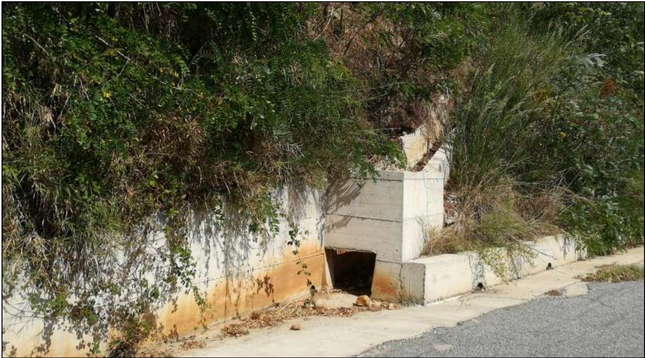
Figura 11-27 - Punto di arrivo dell'opera di drenaggio costruita sul lato del versante che si affaccia sulla ferrovia.
