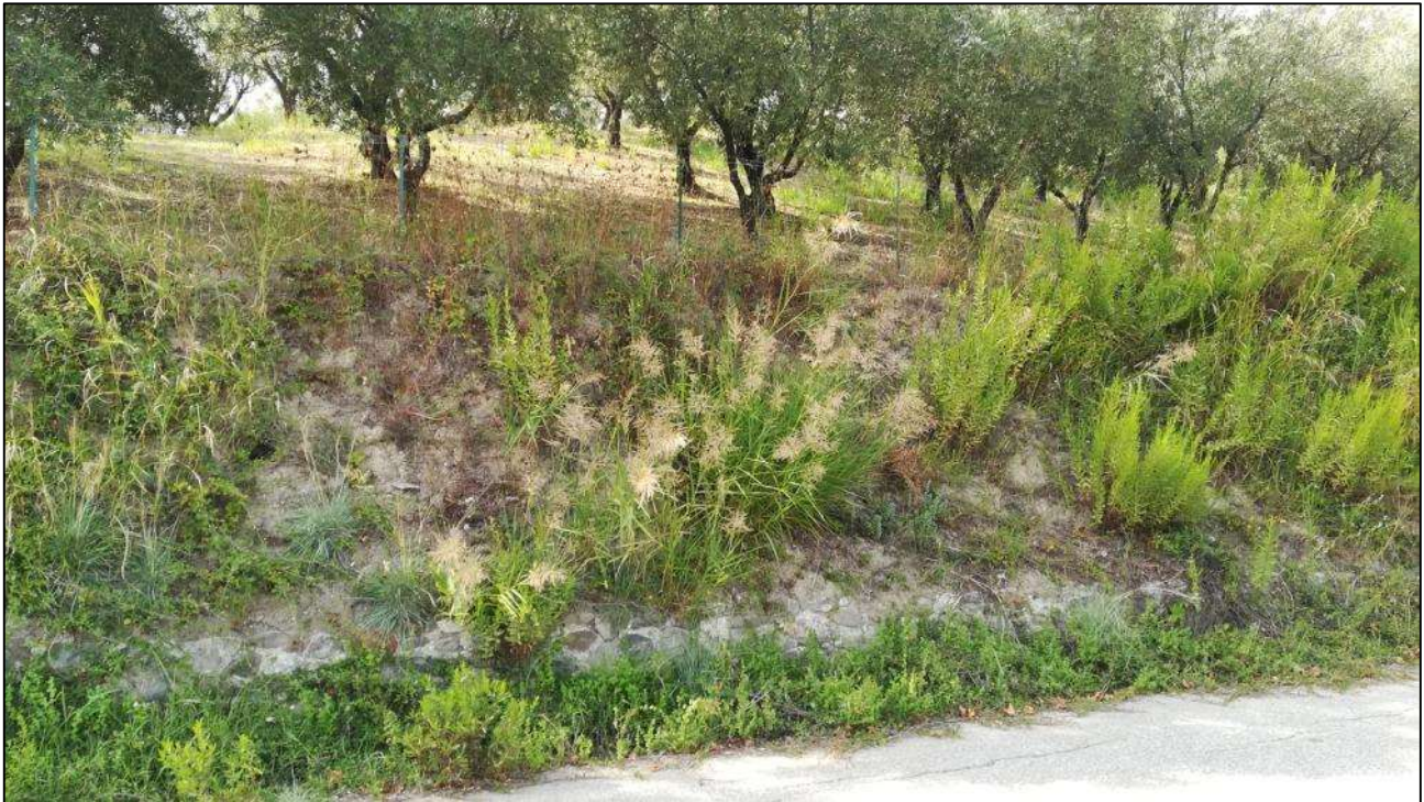
Figura 11-37 - A causa della mancata regimazione delle acque meteoriche si hanno effetti di ruscellamento nelle aree molto acclivi.
