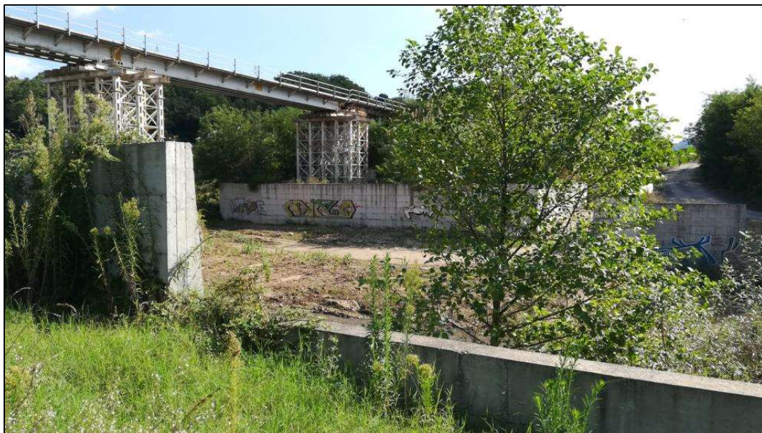
Figura 11-24 - A seguito dell'evento calamitoso avvenuto tra 2009 e 2010, sono stati costruiti, lungo le sponde del Torrente Canello, muri in cemento per limitare l'erosione laterale del corso d'acqua.
