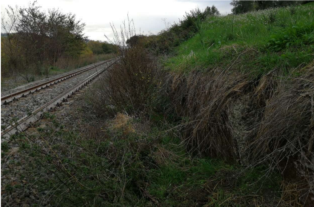
Figura 11-59 – Variante 9, curve 28 e 29. Dettaglio del muro di protezione danneggiato e in lenta rotazione. Il suolo in lento movimento tende a scavalcarlo.
