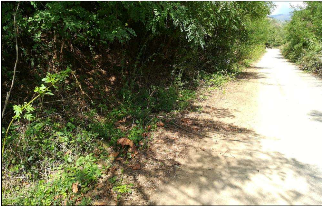
Figura 11-23 - Particolare della S.S. 19 dir. dove non sono stati eseguiti lavori di consolidamento i detriti invadono regolarmente la carreggiata.
