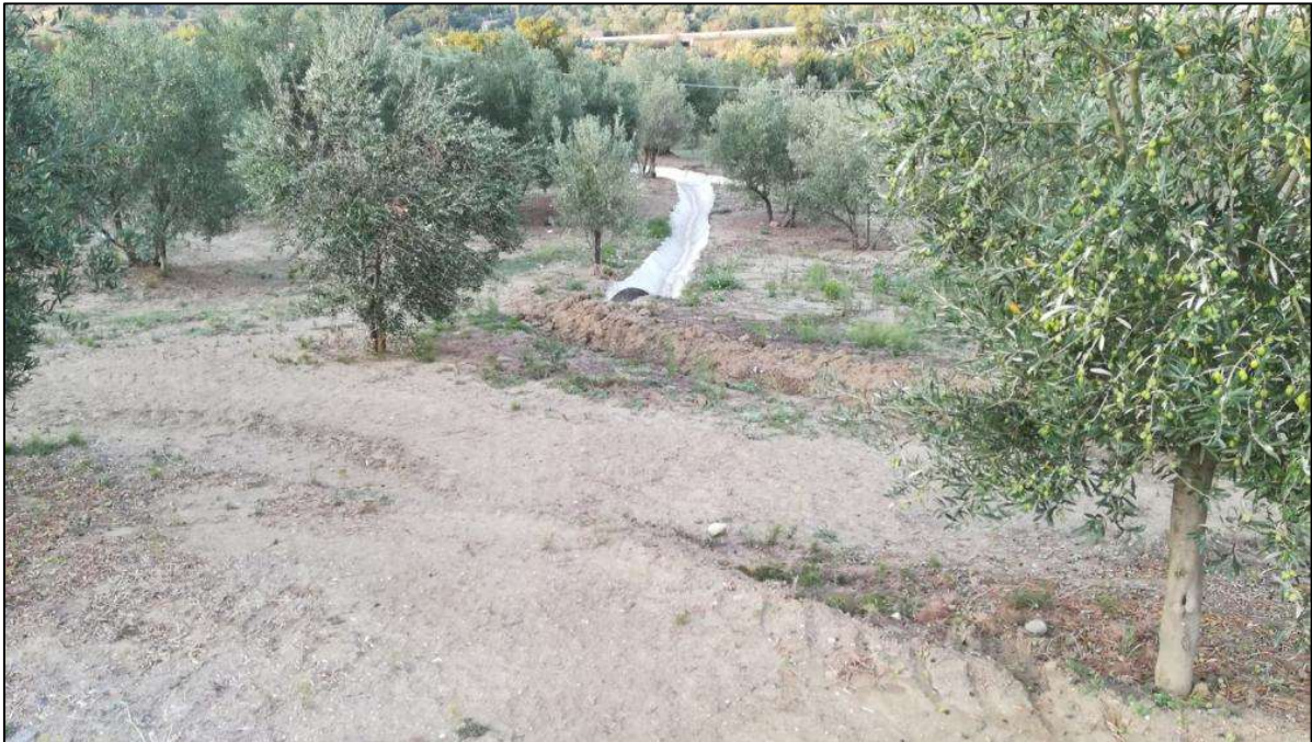
Figura 11-53 - Lungo alcuni tratti di versante sono in corso di realizzazione canali di raccolta delle acque superficiali di ruscellamento.
