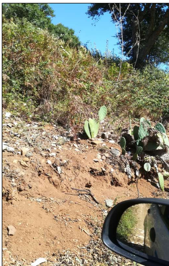
Figura 11-13: Localmente il rilevato della ferrovia risulta soggetto ad erosione.
