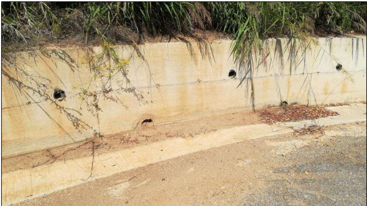
Figura 11-26 - Particolare del muretto di contenimento, localmente superato dai sedimenti che invadono la strada.
