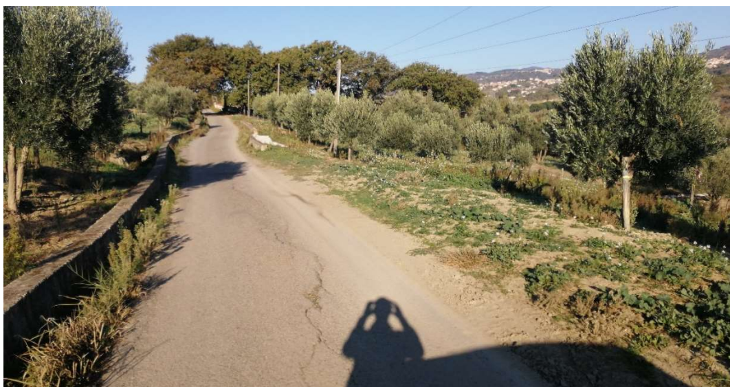
Figura 11-58 – Variante 9, curve 28 e 29. Dettaglio di una strada con evidenti segnali di movimento dell'asse (novembre 2020).
