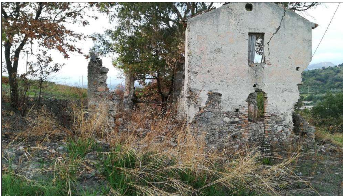
Figura 11-55 - Casa diroccata lungo il pendio, sono evidenti le pareti deformate dai movimenti.
