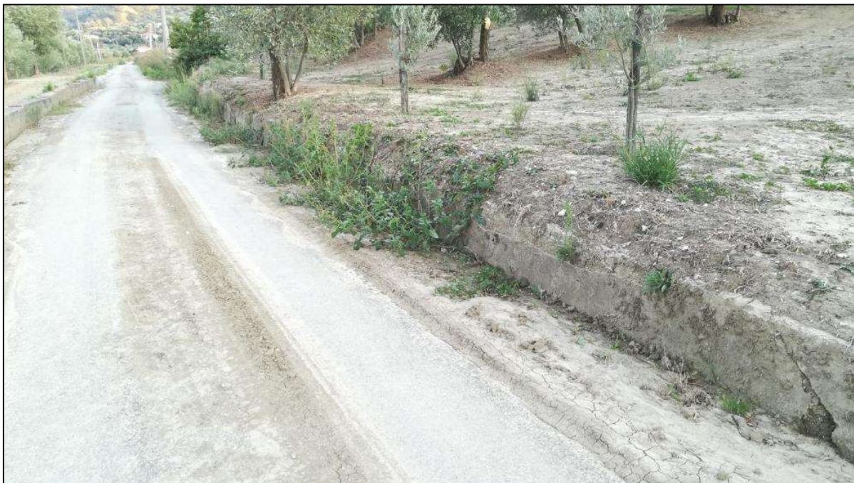
Figura 11-52 - Muretti di contenimento deformati e danneggiati dai movimenti superficiali del terreno e la strada invasa dai sedimenti erosi dai pendii a monte della strada.
