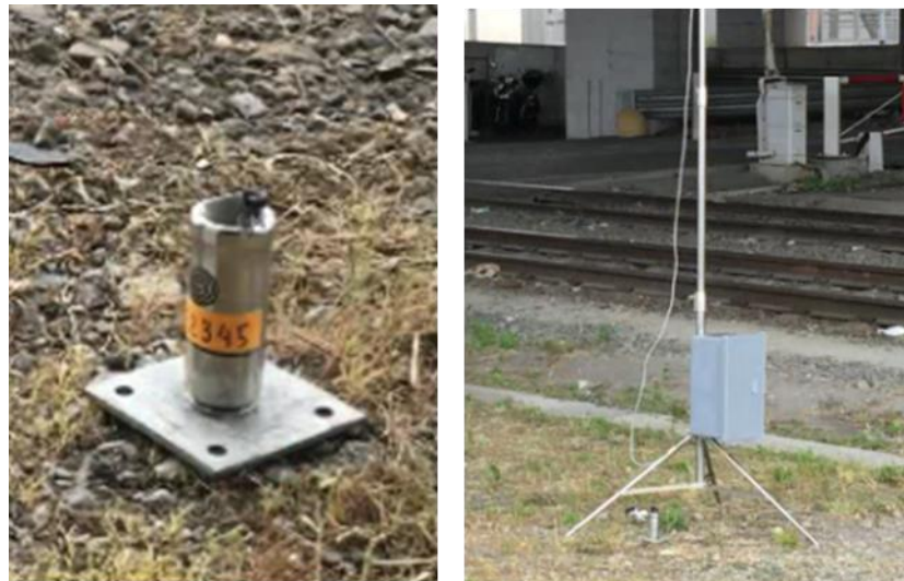
Figura 15-2 Esempio di installazione dell'accelerometro
