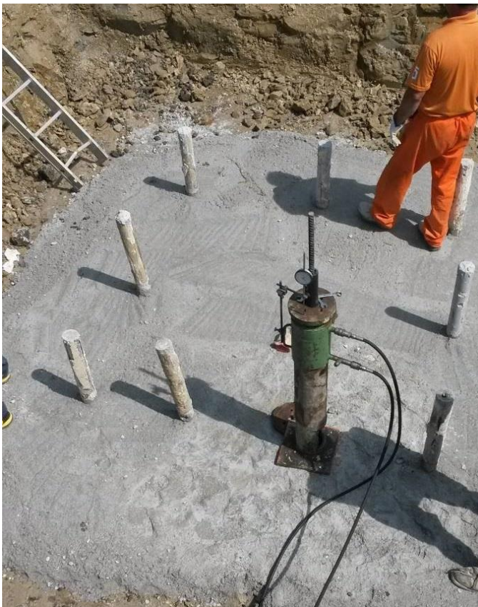
Figura 14 - Realizzazione di micropali tipo tubfix per un sostegno a traliccio; si possono osservare i 9 micropali già realizzati ed iniettati; in questa fase, prima dell'armatura e cassetatura del plinto di fondazione, si sta eseguendo una prova di tenuta del micropalo allo strappamento, al fine di verificare la corretta progettazione e realizzazione dello stesso
