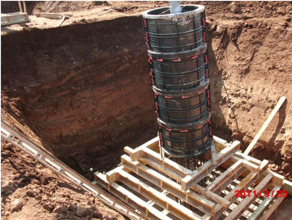
Figura 6 - Realizzazione di fondazioni superficiali tipo CR per un sostegno a traliccio. Nell'immagine si può osservare la fase di cassetteratura
