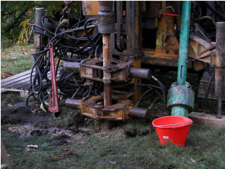
Figura 13 - Macchina operatrice per la realizzazione di micropali tubfix; sistema di scavo a rotopercuSSIONE
