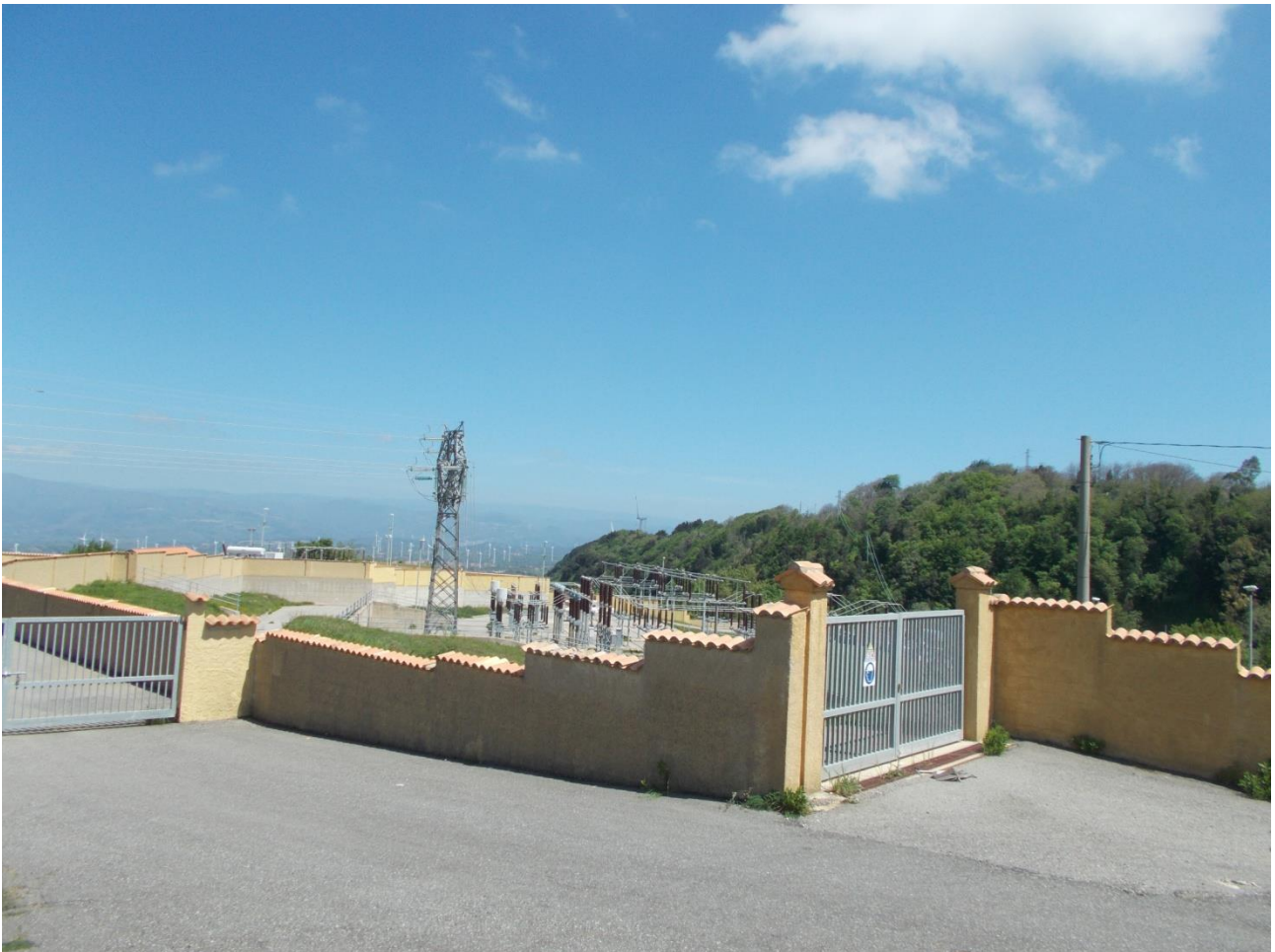
foto 10-Accesso all'area destinata alla realizzazione del nuovo Palo Gatto "PG", interna alla SE di Girifalco
