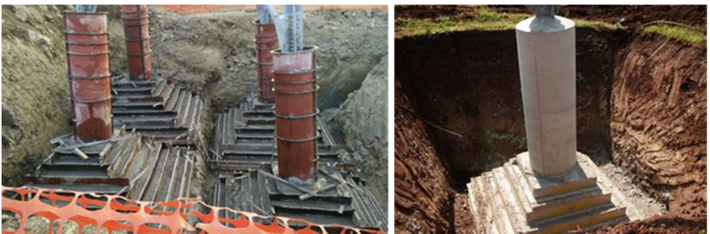
Figura 15: Realizzazione di fondazioni superficiali tipo CR per un sostegno a traliccio. Particolare di una fondazione durante la fase di casseratura (a sinistra) e al termine della stessa (a destra), dove si possono distinguere facilmente la parte inferiore a parallelepipedi tronco piramidali ed il colonnino di raccordo con la "base" del sostegno
