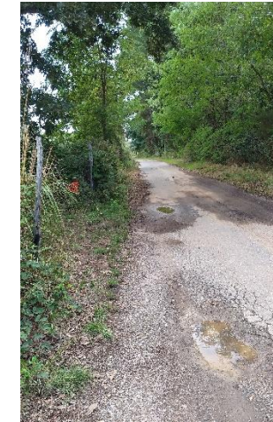
Foto 2 – Strada di accesso al sostegno, sui versanti adiacenti si notano diffusi fenomeni di erosione accelerata e dissesti di versante.
