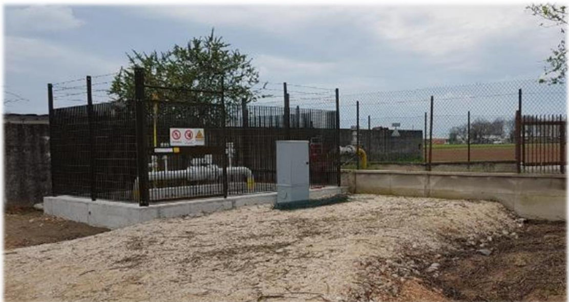
Figura 9-18 – Esempio di impianto al termine dei lavori
