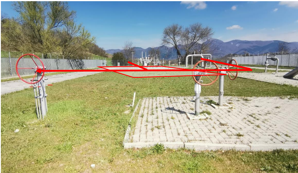
Foto n.76 – Impianto PIDI in progetto all'interno dell'area trappola di Fabriano
