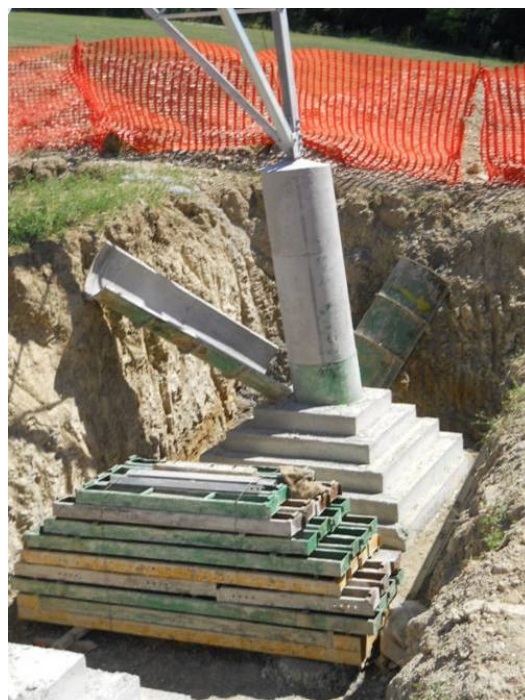
Figura 32: Realizzazione di fondazioni superficiali tipo CR per un sostegno a traliccio. Nell'immagine si può osservare una fondazione CR appena "scasserata". Si possono distinguere facilmente la parte inferiore a parallelepipedi tronco piramidali ed il colonnino di raccordo con la "base" del sostegno (immagine d'archivio)
