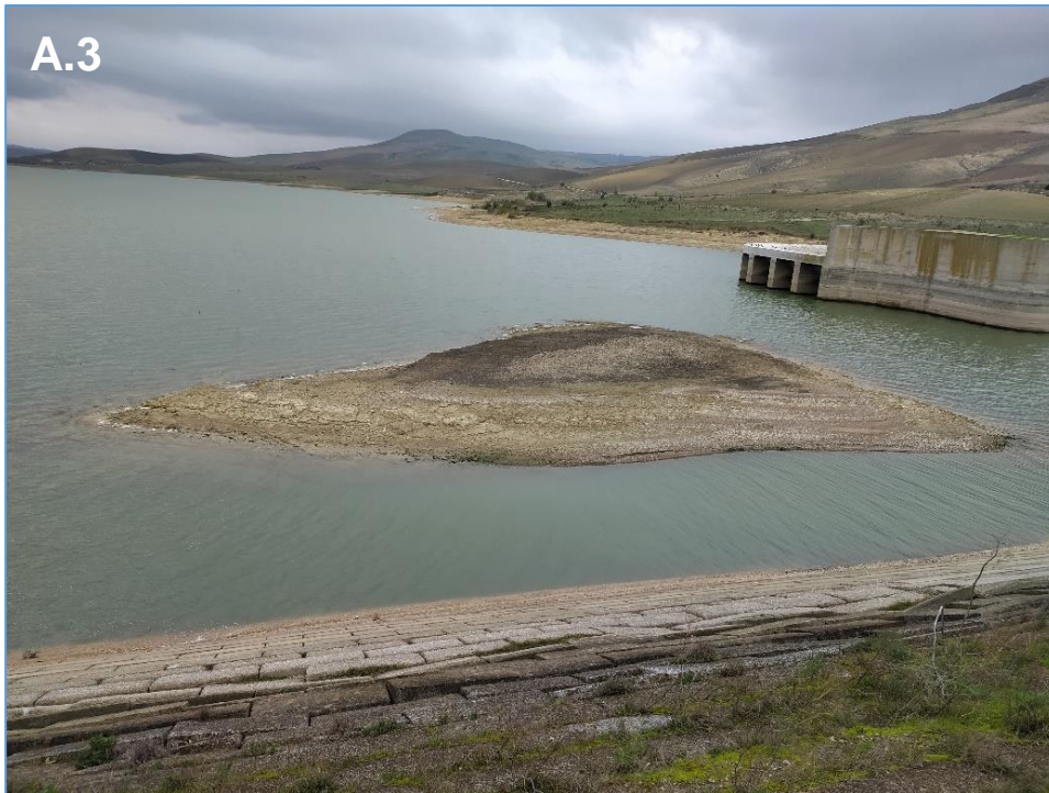
Figura 5. Segni evidenti di interrimento si riconoscono nell'invaso di Serra del Corvo proprio dinnanzi alle opere di presa di EIPLI.
