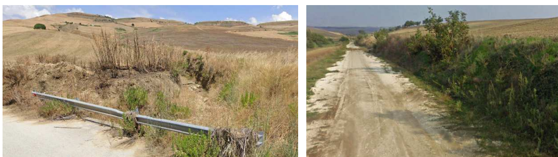
Figura 2. Il fossato non regimato che degrada dai versanti in erosione nei pressi della diga di Serra del Corvo (a, a sinistra) e piccolo canale di drenaggio lungo la strada di accesso al sito dove verrà realizzato l'invaso di monte (b, a destra).
