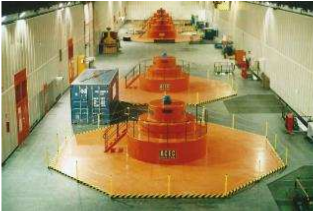
Figura 69. L'interno di una centrale di produzione a pompaggio interrata nelle Alpi da cui si apprezzano le dimensioni e gli ingombri delle macchine.
