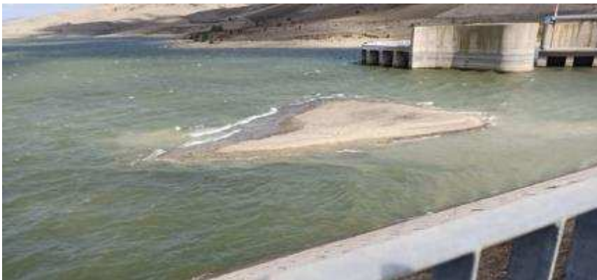
Figura 54. Sedimenti accumulati in corrispondenza del paramento di monte.
