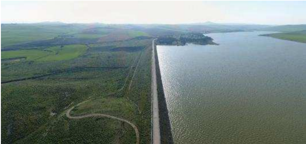
Figura 139. Il coronamento della diga di Serra del Corvo lungo il quale si muove il recettore N.
