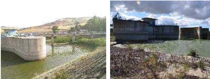
Figura 92. Zone degradate nei pressi delle opere esistenti esercitate da EIPLI.
