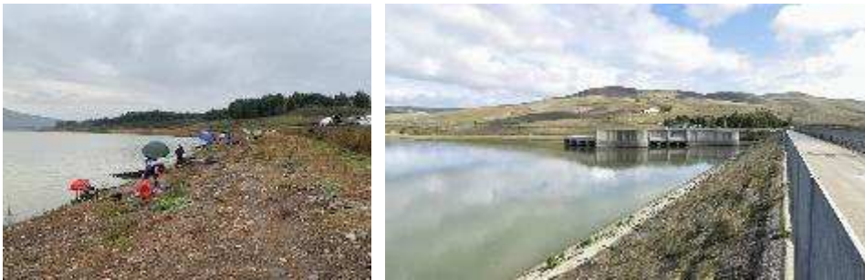
Figura 93. Alcuni tratti litorali degradati e il paramento di monte della diga di Serra del Corvo.
