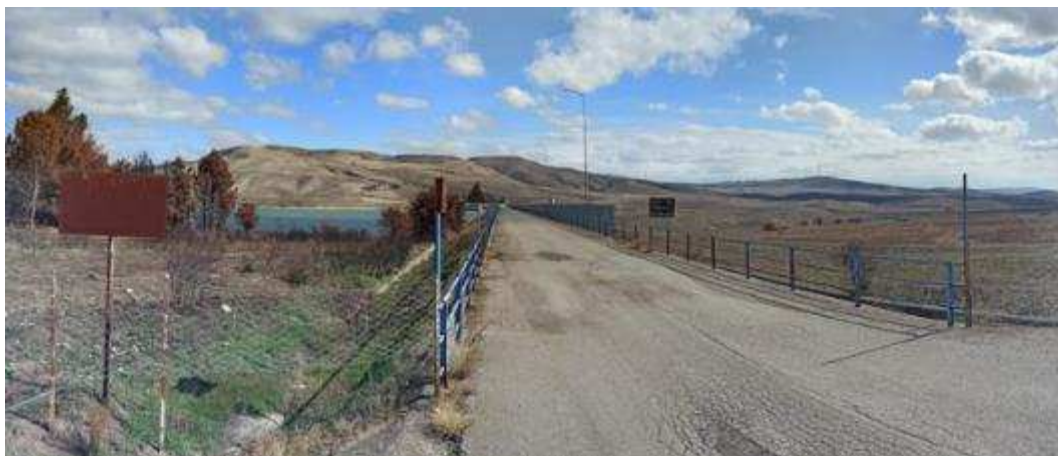
Figura 55. Stato di abbandono di recinzioni, cartellonistica, vegetazione e strada visibilmente ammalorata.
