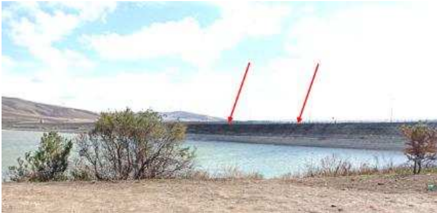
Figura 53 Paramento di monte della diga. Le frecce indicano la presenza di vegetazione tra le piastrelle del paramento di monte.
