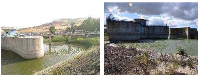
Figura 12. Zone degradate nei pressi delle opere esistenti esercitate da EIPLI.
