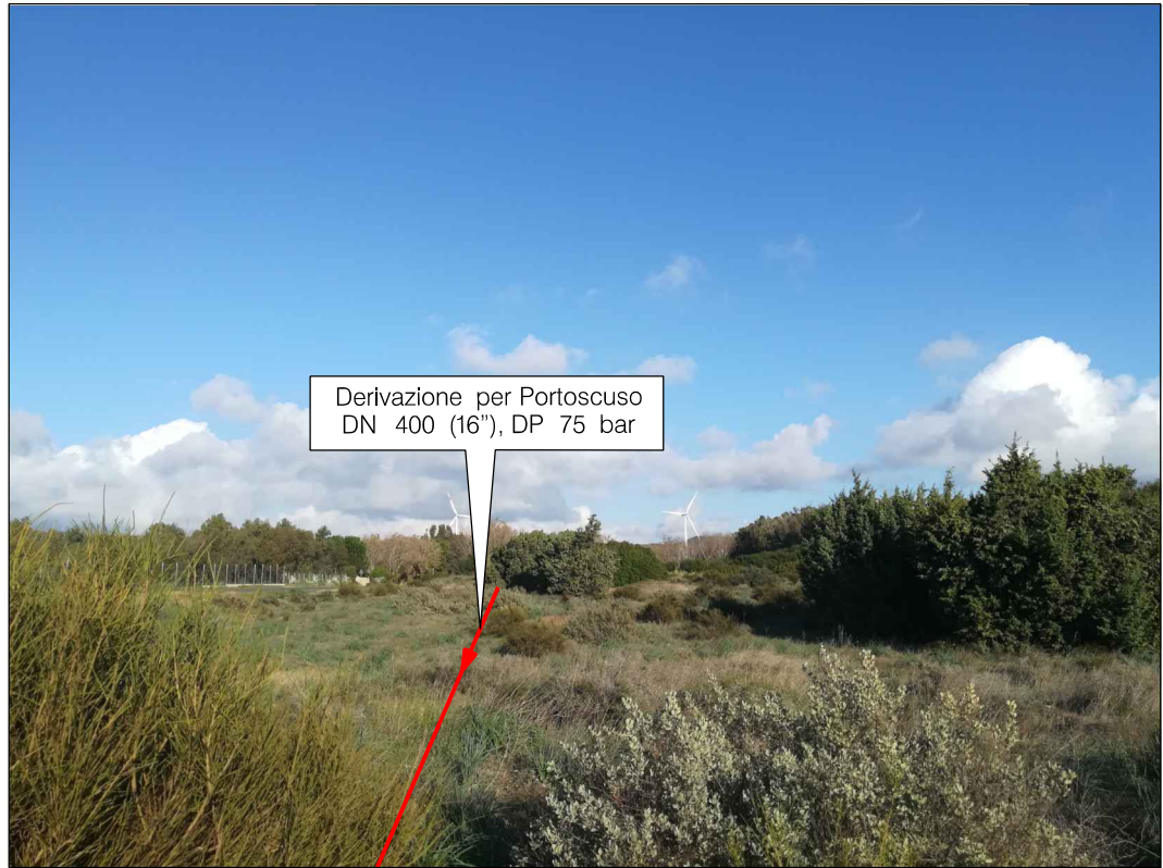
Ulteriore vista della condotta in zona alberata tra la S.P. n. 2 e l'Area Industriale di Portovesme, nel comune di Portoscuso
