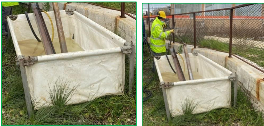
Figura 4: Esempi di lavaggio delle attrezzature di carotaggio dopo ogni battuta (foto di repertorio).
