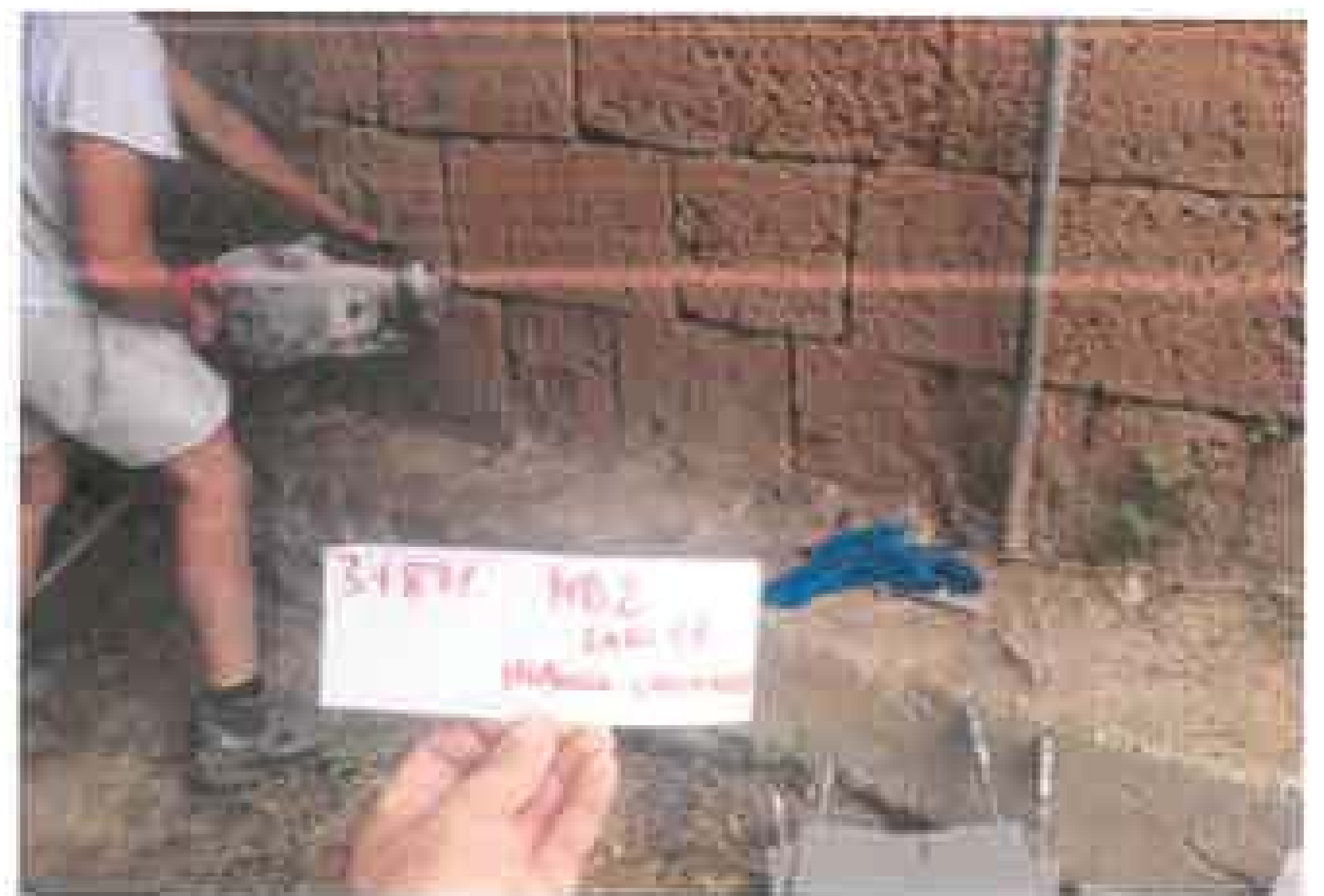
Foto 2 Taglio inferiore della muratura
