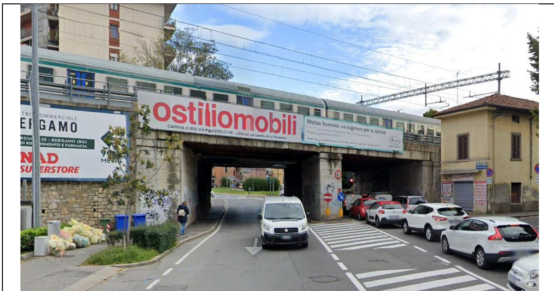
Vista dell'impalcato di Via San Bernardino da demolire e ricostruire (VI03)
