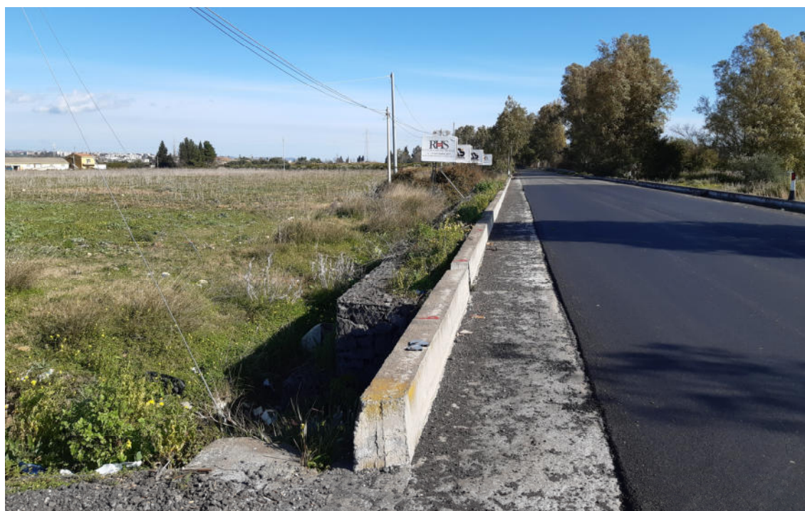
Vista dell'intersezione tra SP701 e accesso alla viabilità di cantiere della NV1 1
