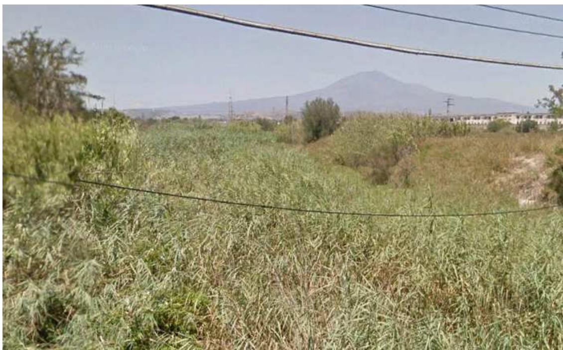
Figura 5-8- Foto del tratto in cui il corso del Vallone Mendola affluisce all'interno del Canale Buttaceto.
