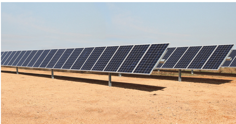
Fig. 5 - Palo del tracker infisso nel terreno
