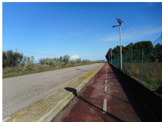
22 - Località Pozzelle-Strada Provinciale 88, tratto di cavidotto diretto a NE visto da SW.
