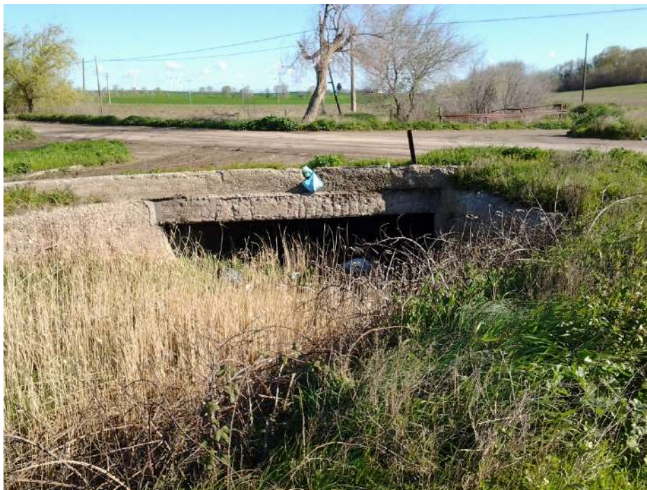
Foto 5. Vista delle condizioni del sovrappasso del canale che sarà attraversato con tecnologia "No-dig".
