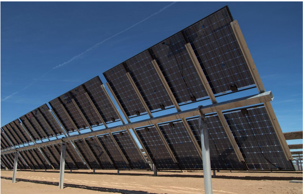
Figura 5: Esempio struttura + modulo FV bifacciale
