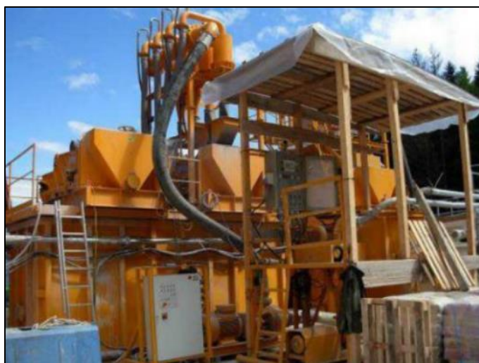
Figura 2—S: Sistema di disidratazione
