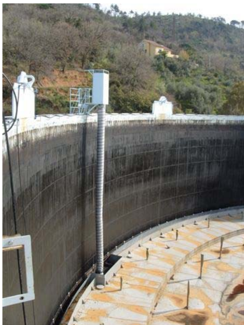
Figura 2: Guaina per tubi guida e di campionamento di serbatoi
