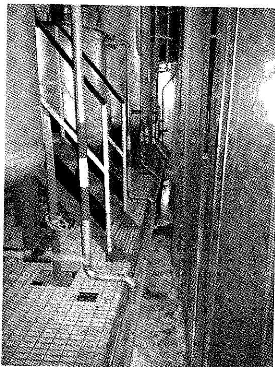
Figura 2: Area stoccaggio ammoniaca - particolare serbatoi
