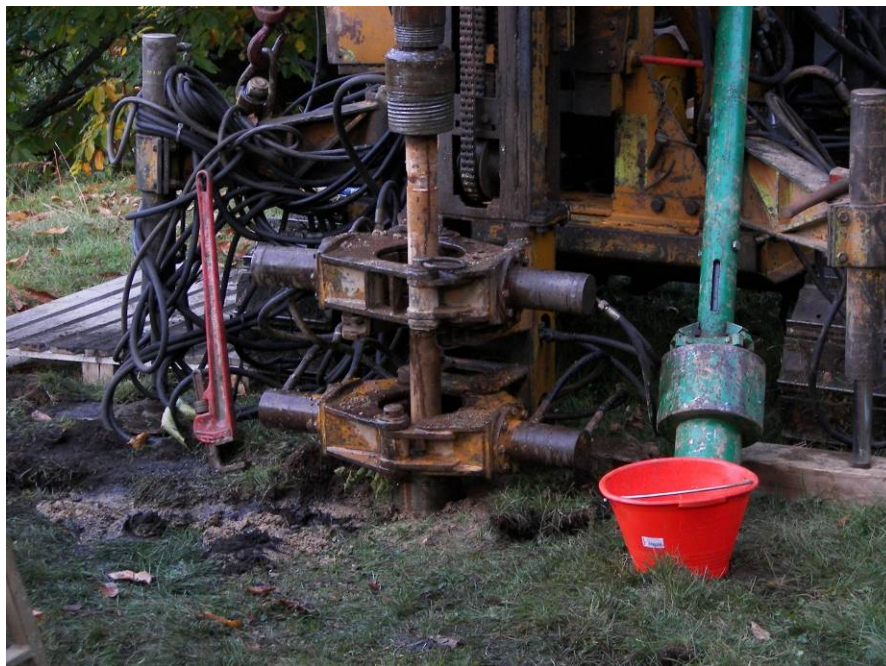
Macchina operatrice per la realizzazione di micropali tubfix; sistema di scavo a rotopercussione
