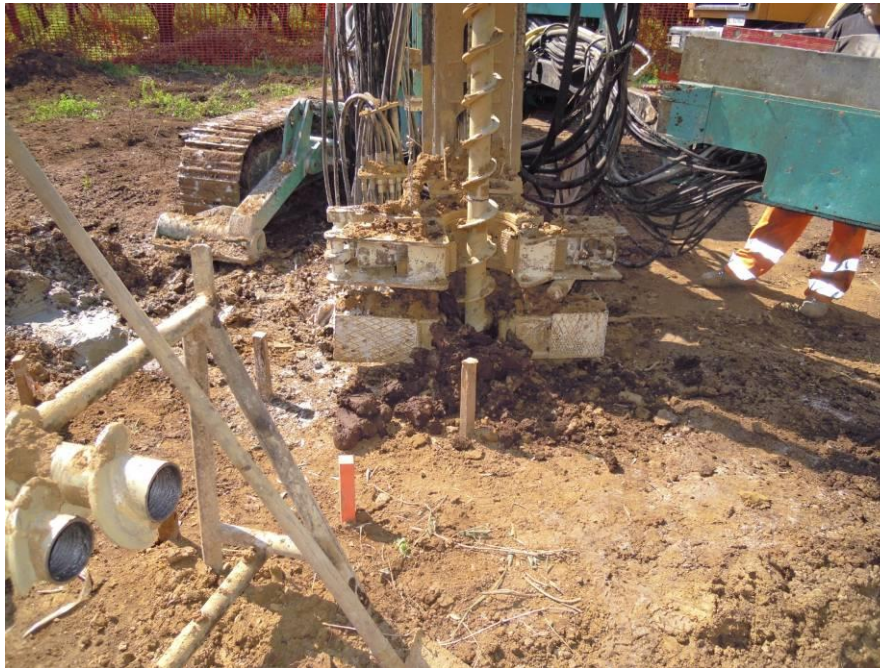
Figura 19: Macchina operatrice per la realizzazione di micropali tubfix; sistema di scavo mediante trivella elicoidale
