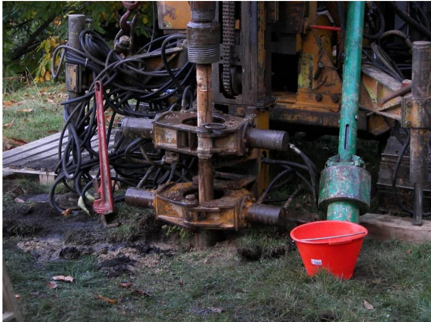
Macchina operatrice per la realizzazione di micropali tubfix; sistema di scavo a rotopercolazione
