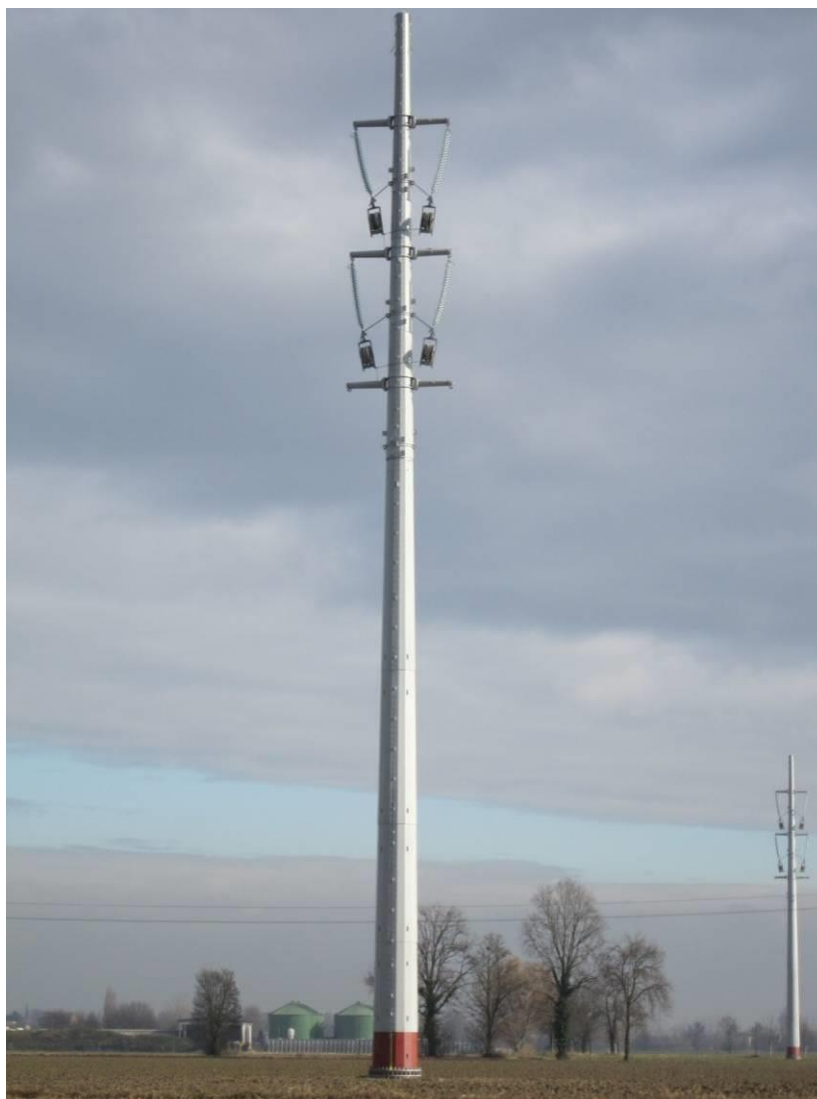
Sostegno monostelo montato. Si notino le carrucole collegate alle catene degli isolatori, fase che precede la “tesatura” dei conduttori
