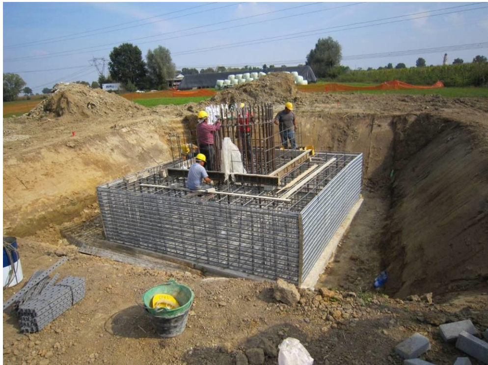
Realizzazione di fondazione superficiale tipo plinto a monoblocco per un sostegno monostelo. Nell'immagine si può osservare la fase di cassetatura
