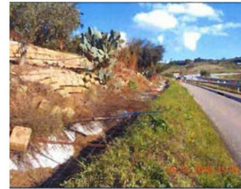
Figura 1 Area di dissesto a seguito degli eventi di Novembre 2018
