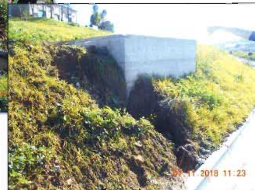
Foto 6 – SV06 (TP49 – Pozzetto di monte)
