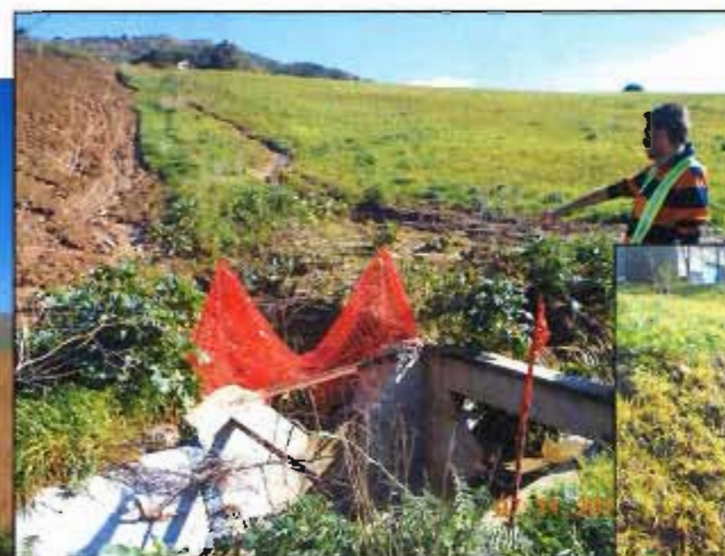
Foto 5 – TS29 (Pozzetto di monte)
