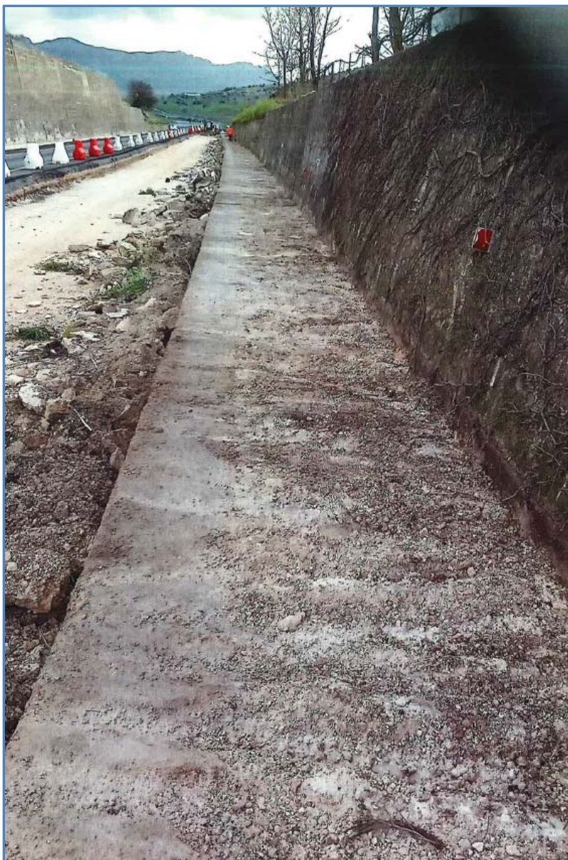
Figura n. 10 – Immagine fotografica della fondazione del muro in dx del tratto di asse principale AP11 compreso tra la Sez. 702 + 7,00 m e la Sez. 711 + 17 m, sul quale sono stati rimossi gli strati in conglomerato cementizio e bituminoso aventi spessore 20 cm
