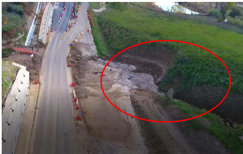
Figura 1 Danneggiamenti a valle del TP5 a seguito degli eventi alluvionali di Novembre 2018
