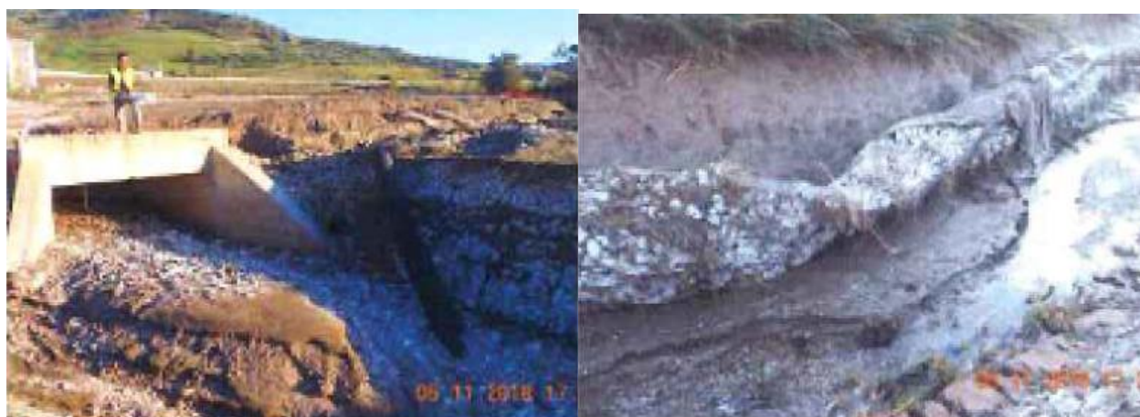
Figura 1 DANNEGGIAMENTI SF25 A SEGUITO DEGLI EVENTI DI NOVEMBRE 2018
