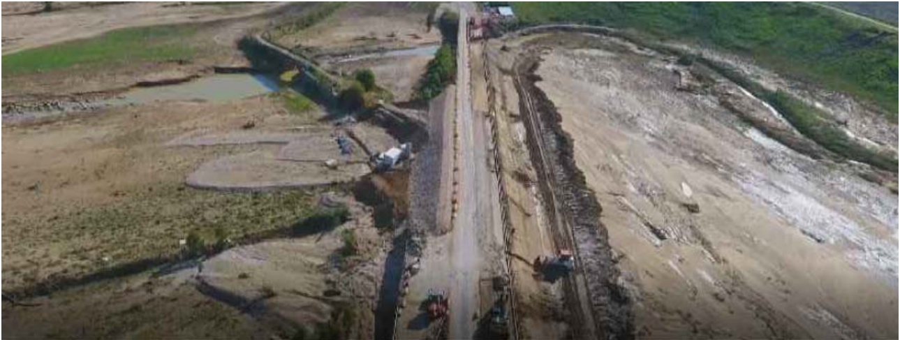
Figura 1 Foto da drone dell'area in esame a seguito dell'evento di novembre 2018; a destra i danni provocati al rilevato del tratto AP15
