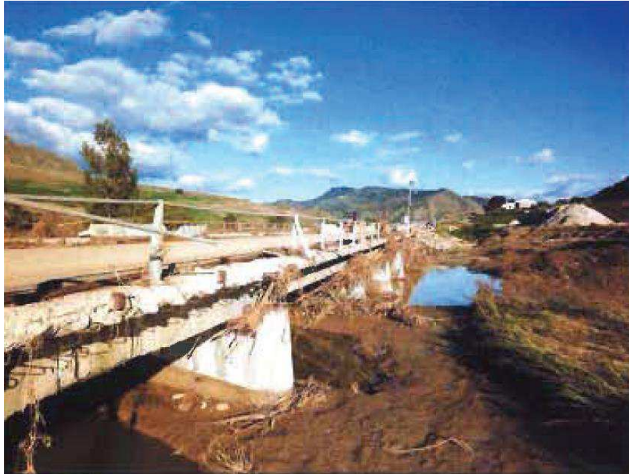
Figura 3 Viadotto San Leonardo. Immagine scattata in seguito agli eventi di Novembre 2018
