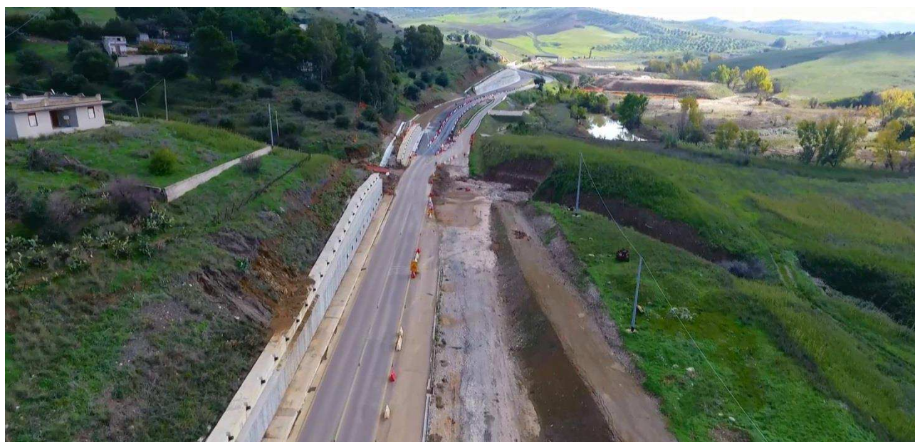
Figura 1- SCOSCENDIMENTI SUPERFICIALI IN SOMMITÀ DELLA PARATIA OS03
