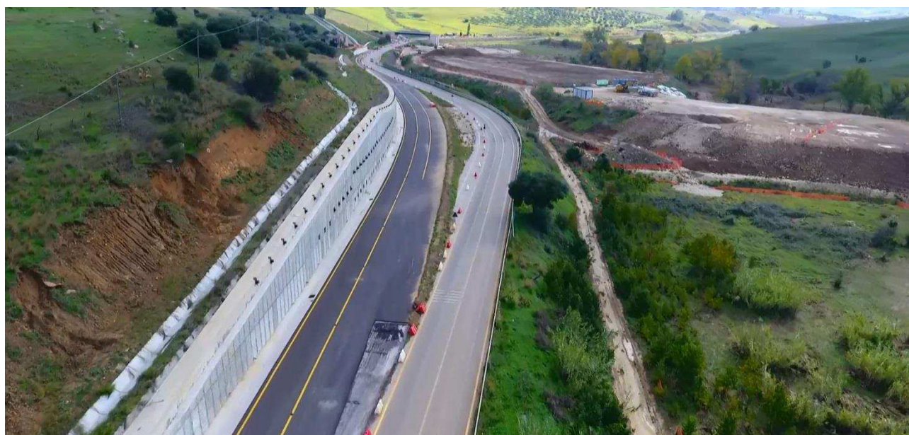
Figura 1- SCOSCENDIMENTI SUPERFICIALI IN SOMMITÀ DELLA PARATIA OS05
