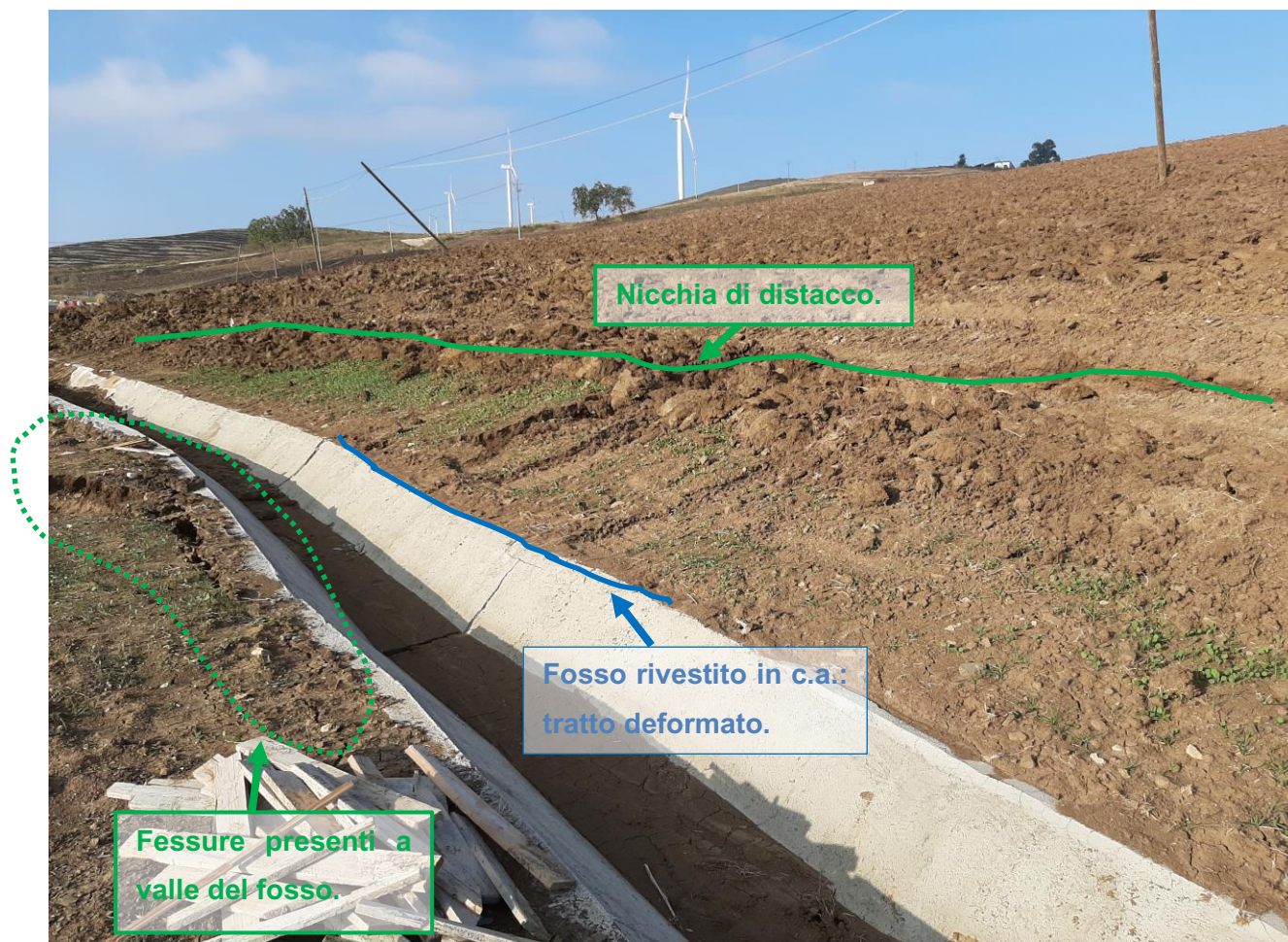
Figura 9: Foto scatta durante il sopralluogo: fosso rivestito in c.a. deformato.
