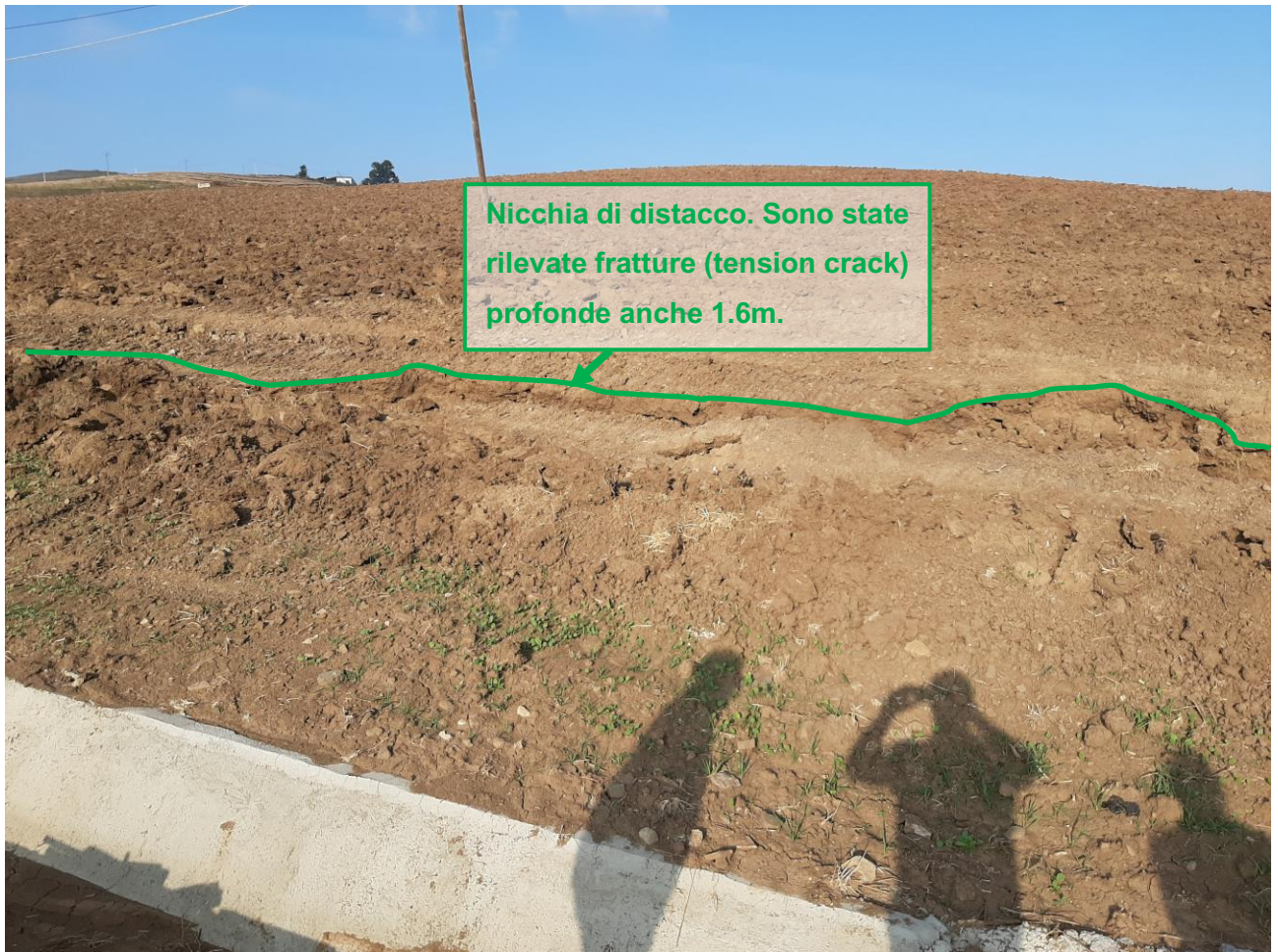
Figura 8: Foto scatta durante il sopralluogo: nicchia di distacco.
