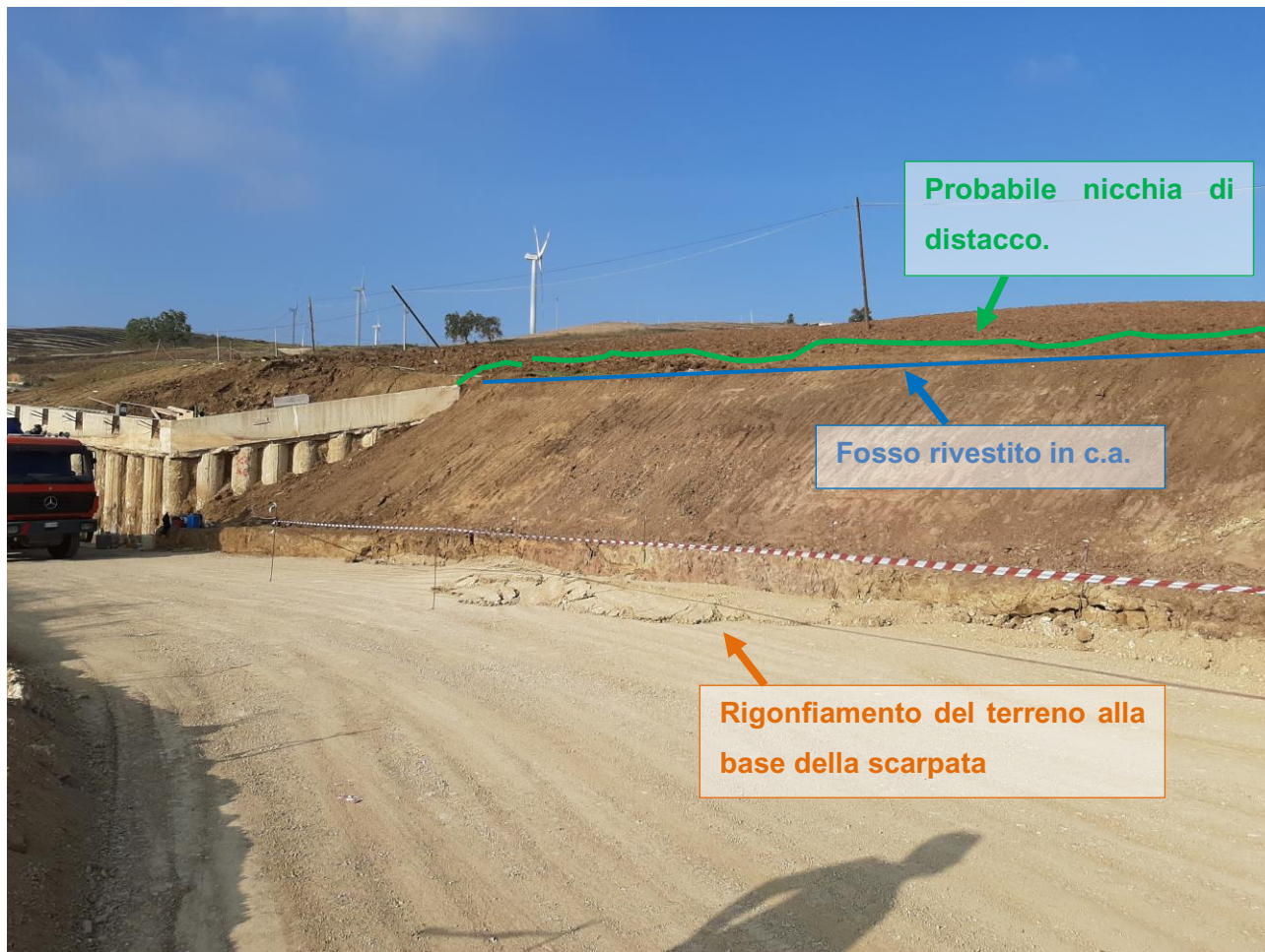
Figura 6: Foto scatta durante il sopralluogo: alla base della scarpata si evidenzia il rigonfiamento a seguito del movimento franoso.
