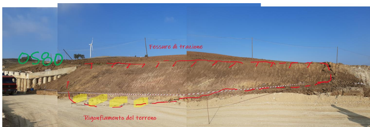
Fig. 10. Foto panoramica del tratto franato.
