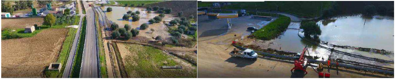
Figura 3 Allagamento area nuovo tombino TP77 a seguito degli eventi di novembre 2018
