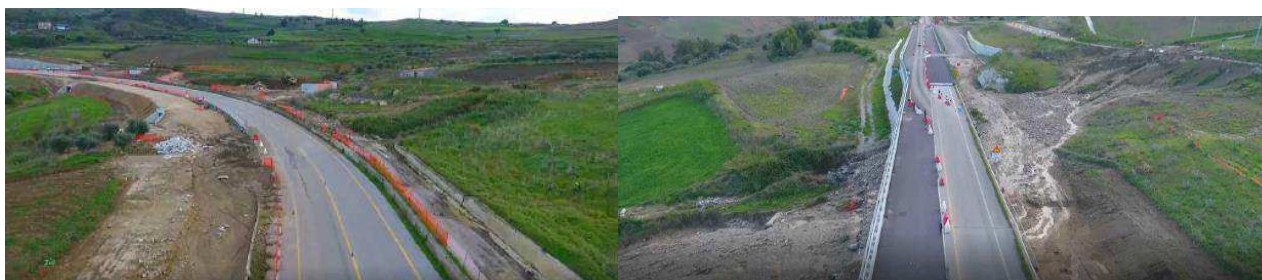
Figura 1 Danneggiamenti inalveazioni a seguito degli eventi di novembre 2018 Zona San Giorgio
