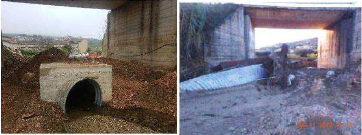
Figura 1 Danneggiamenti TP25 a seguito degli eventi alluvionali di Novembre 2018
